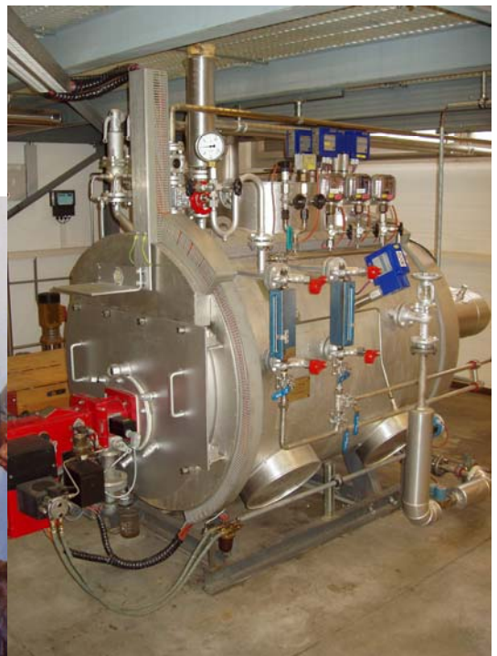
Chaudière de l'IGT utilisée pour la formation et l'examen
